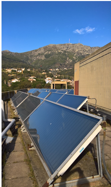
Panneaux solaires thermiques installés sur le toit du Centre Hospitalier de Bastia
